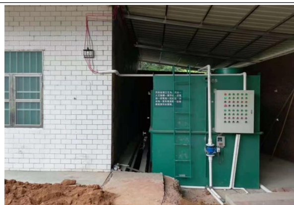
一体化污水站
